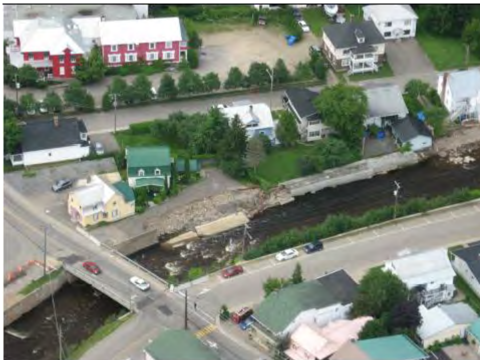
FIGURE 1 : BRIS DU MUR DE PROTECTION DANS LE SECTEUR DU PONT GARIÉPY ET DE LA RUE MORIN, JUILLET 2008
