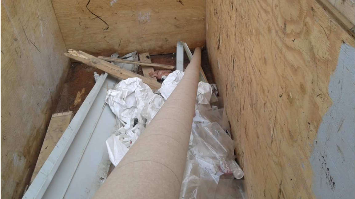
Photographie 18 : Résidus de rénovation à Kuujuaq (Source Pierre-Luc Dessureault)
