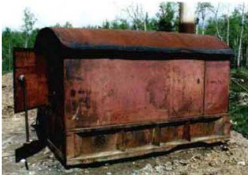
Photographie 1 : Boîte de brûlage métallique fermée
